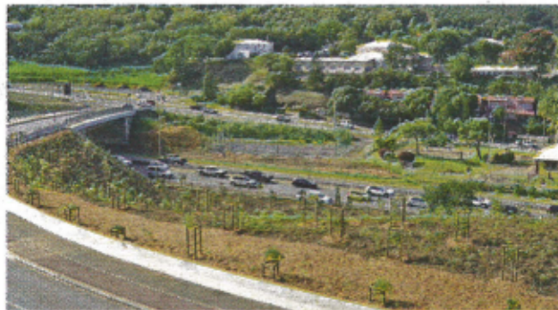
Le chantier, qui devait durer deux mois et demi, se finira finalement en septembre, à cause des intempéries.
